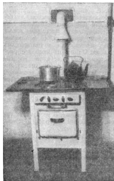
Газовая плита с отводом продуктов сгорания в дымоход.
